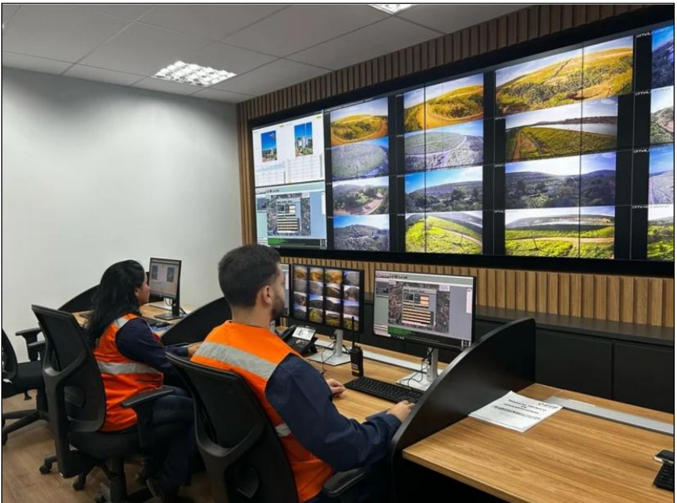
Figura 6.1– Centro de Monitoramento Geotécnico (CMG).
